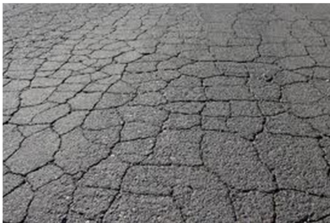
Hình 1-9. Hư hỏng nứt mỏi mặt đường BTN
